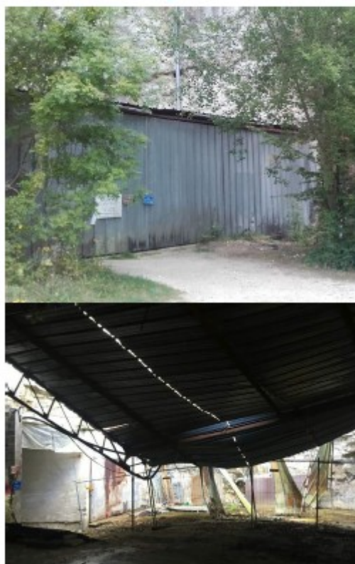
Photographie 3 : Hangar empêchant l'accès aux galeries
